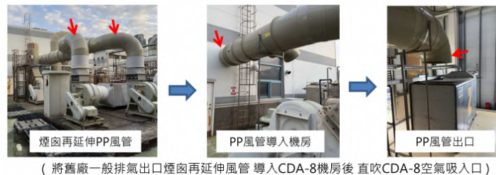
( 將舊廠一般排氣出口煙囪再延伸風管 導入CDA-8機房後 直吹CDA-8空氣吸入口 )
