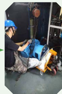
▲ 2022 年安排廠商更換空壓機
